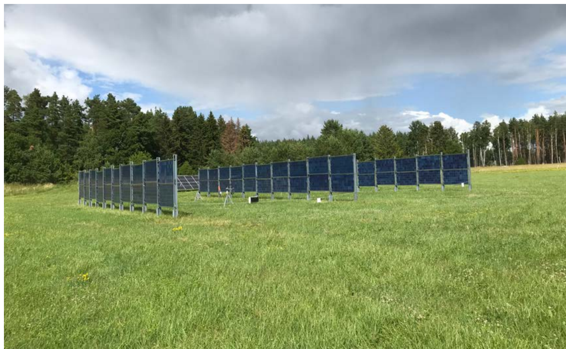
På Kärrbo Prästgård utanför Västerås har ett agrivoltaiskt forskningsprojekt pågått sedan början av året, där man kombinerar solceller med odling på jordbruksmark.
